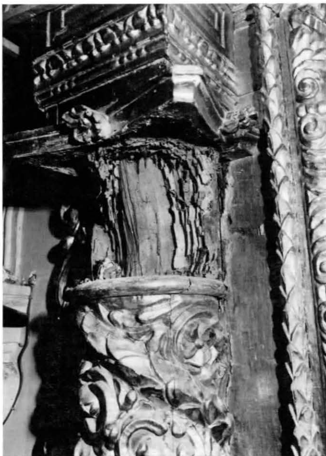
7 - MATERA, CATTEDRALE DELLA MADONNA DELLA BRUNA PARTICOLARE DELLA CORNICE LIGNEA DELL'ALTARE DI SANT'ANNA (PRIMA DEL RESTAURO)
