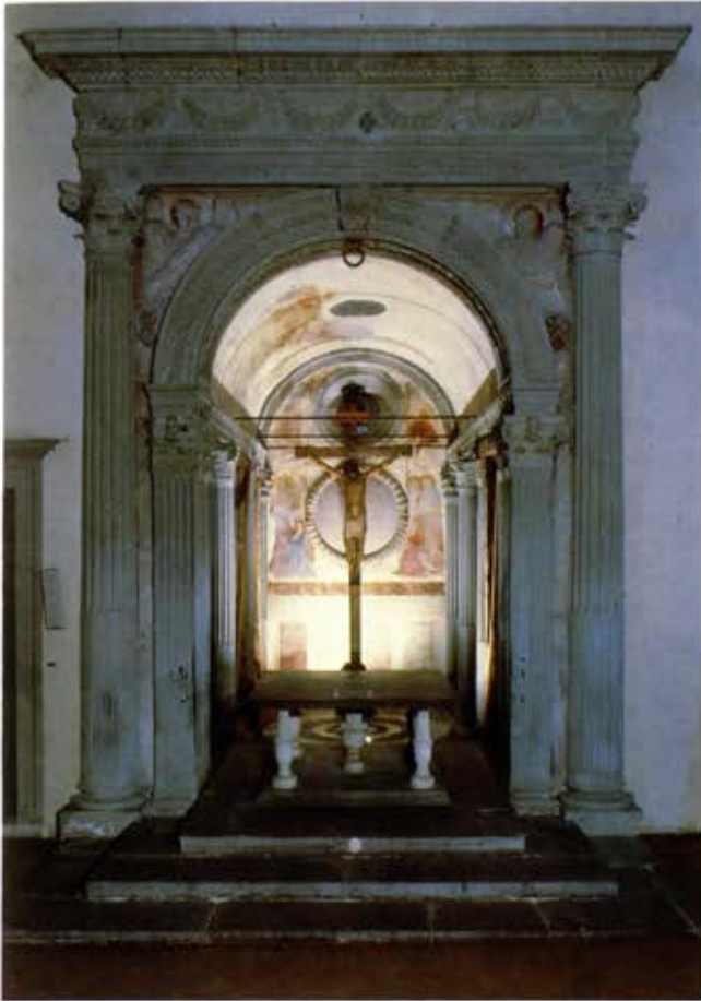
a) PESCIA, CAPPELLA CARDINI, STATO ATTUALE Le strutture portanti sono in parte lesionate e puntellate; vi sono vaste infiltrazioni di umidità.
