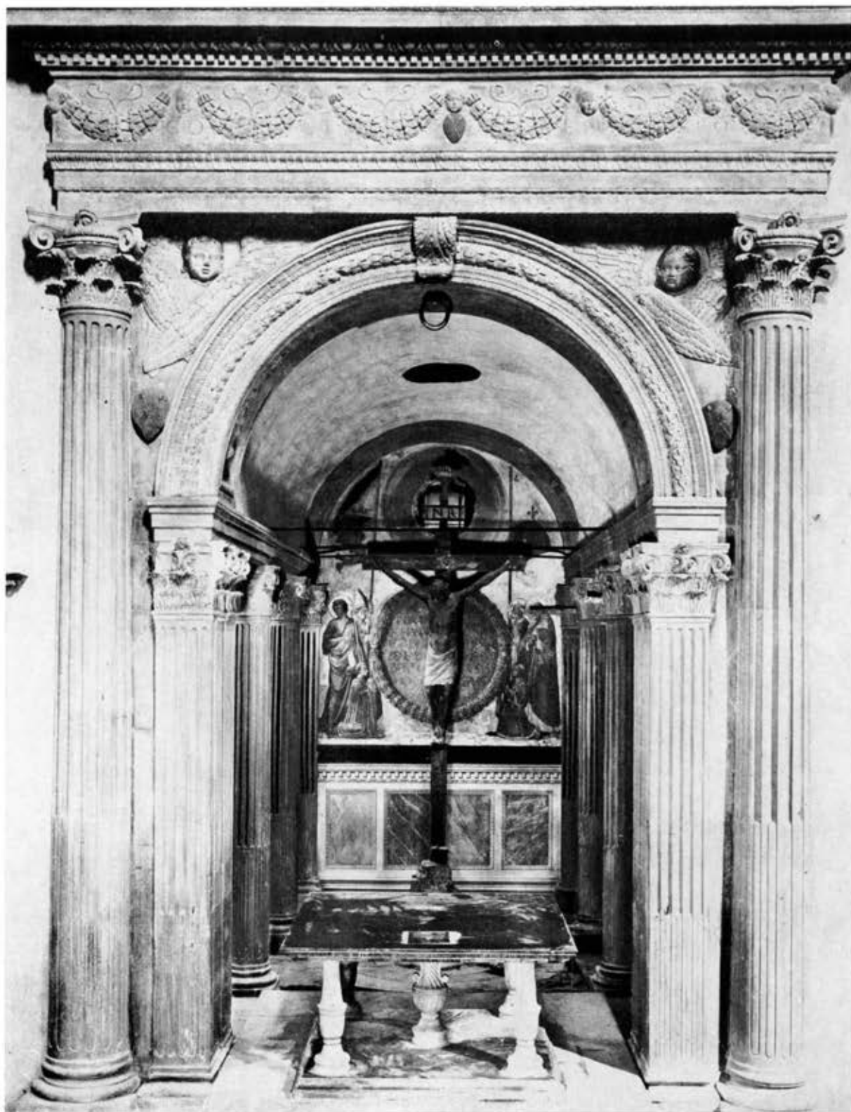
I - PESCIA, CHIESA DI SAN FRANCESCO, CAPPELLA CARDINI DOPO L'INTERVENTO DEGLI ANNI '20 (NUCCI) Sono stati suturati i giunti, reintegrate le lacune della fuseruola dell'architrave, realizzato (?) lo zoccolo ad imitazione di marmo sotto l'affresco di Neri di Bicci. (foto Brogi N. 23906)
