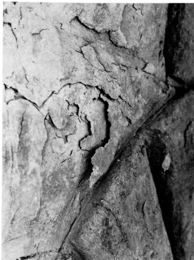
2 - SIENA, PALAZZO DI SAN GALGANO PARTICOLARE DELLA FACCIATA Fenomeni di esfoliazione della pietra con più "squame" sovrapposte.
