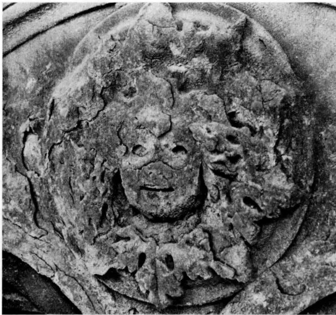
6 - SIENA, PALAZZO DI SAN GALGANO PARTICOLARE DELLA FACCIATA Aspetto del degrado su un rosone scolpito
