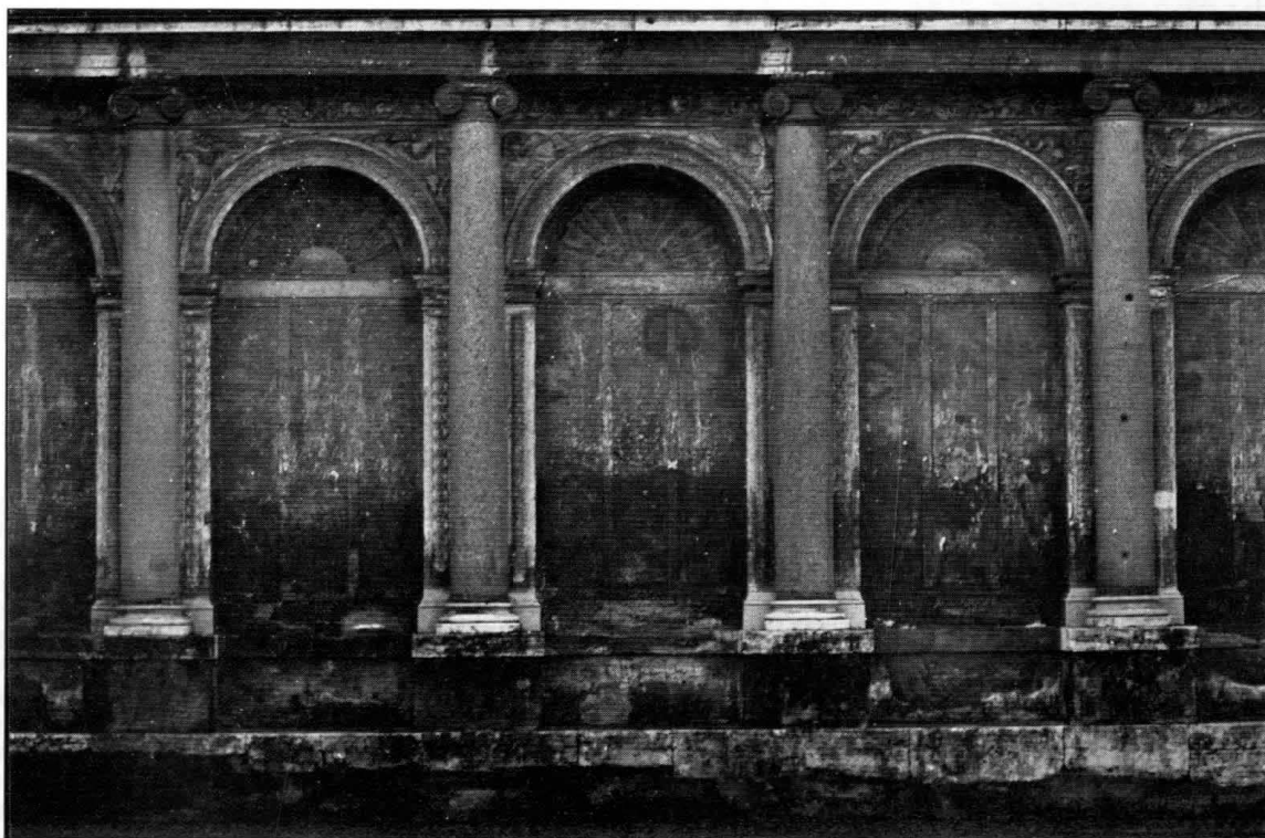
5 - ROMA, VILLA GIULIA, PRIMO CORTILE Effetti provocati dall'umidità di risalita capillare sulla decorazione a stucco.
