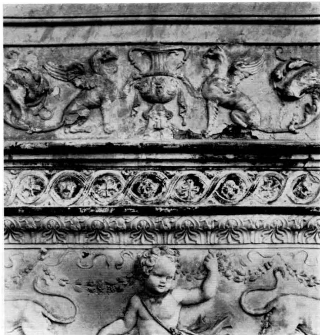
21 - ROMA, VILLA GIULIA, PRIMO CORTILE, FACCIATA DI FONDO PARTICOLARE DEL PANNELLO DI SINISTRA Danni causati dalle infiltrazioni d'acqua.
